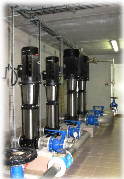
Station d'Uzemain : pompage de l'eau
